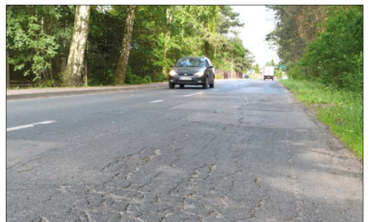
Stan jezdni na ul. Izabelińskiej wymaga pilnego remontu.
